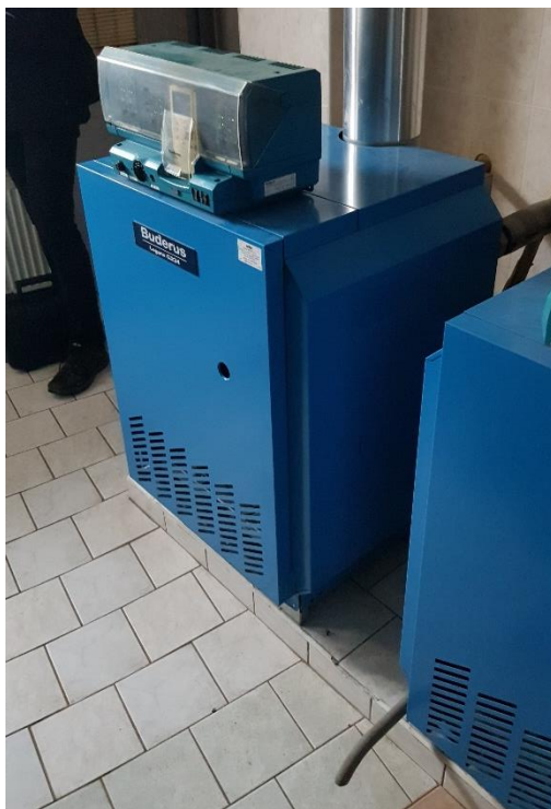
Obrázek 21 Plynové teplovodní litinové kotle Hydrotherm
